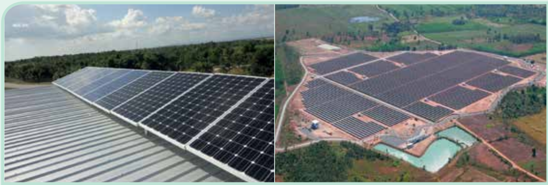
โรงผลิตไฟฟ้าพลังงานแสงอาทิตย์จากโซลาร์เซลล์
