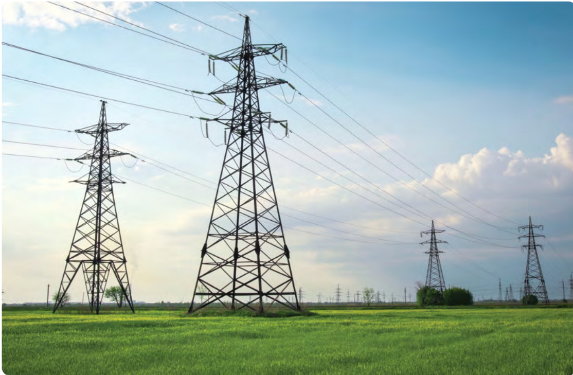
ระบบสายส่งและสถานีไฟฟ้าแรงสูง
